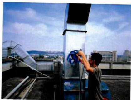
G7 注塑脱模排气筒出口
