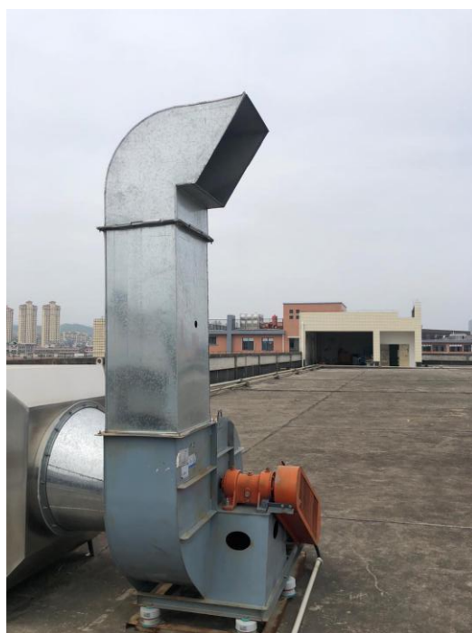
注塑废气排气筒
