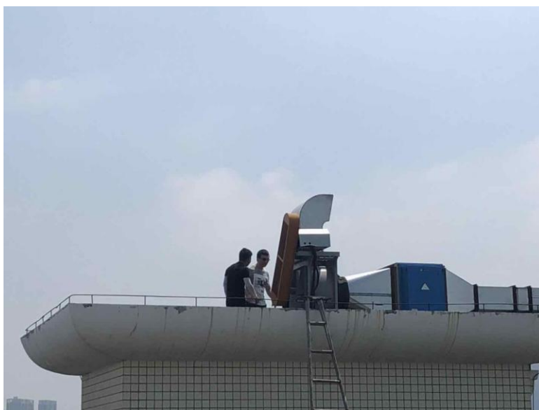
食堂油烟排气筒
