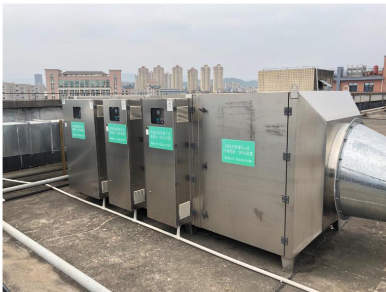
有机废气处理设施
