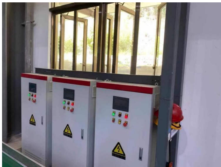
废气处理设施控制箱
