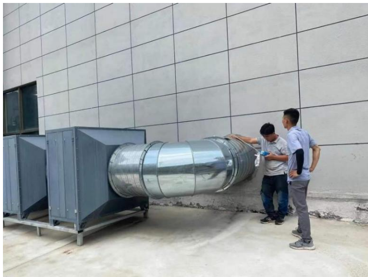
废气处理设施排气筒
