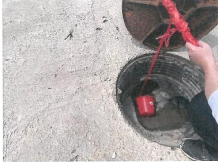
W1 生活污水总排放口
