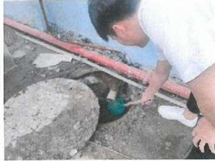
W1 生活污水出口
