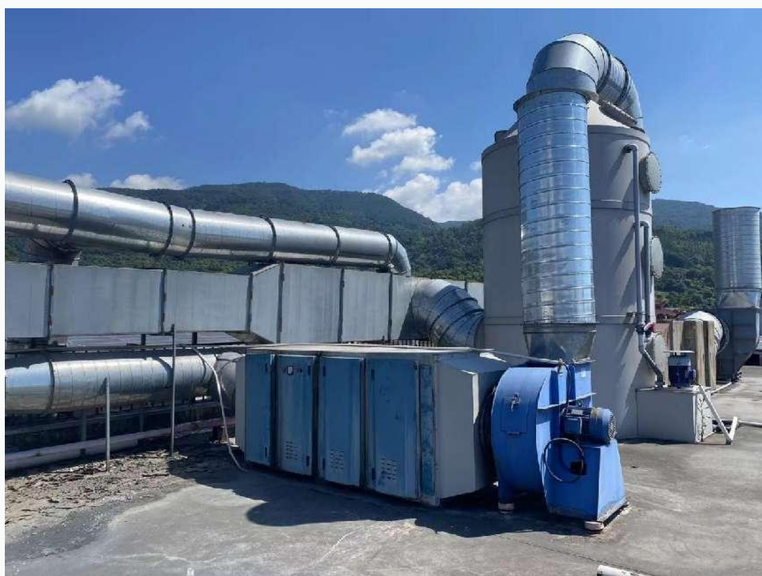
喷漆等有机废气处理设施
