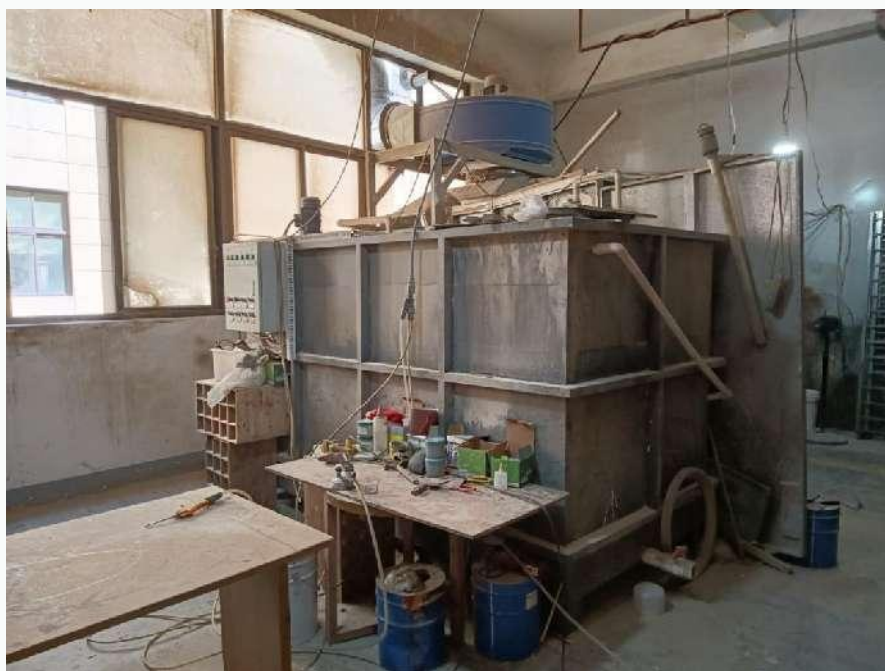
废水处理设施
