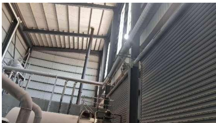
废气收集管道
