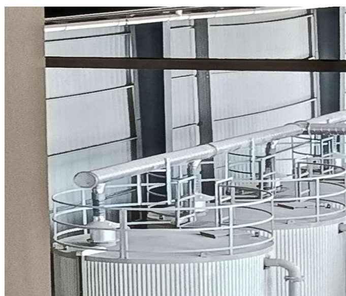
沥青罐呼吸废气收集管道
