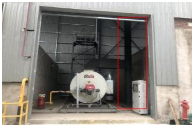
导热油炉 15m 高排气筒
