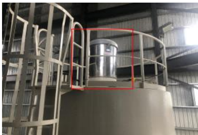
矿粉仓顶部除尘风帽
