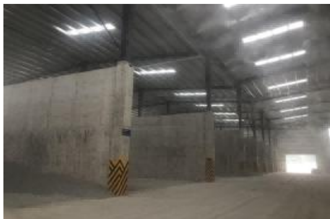
原料堆场喷雾降尘设施
